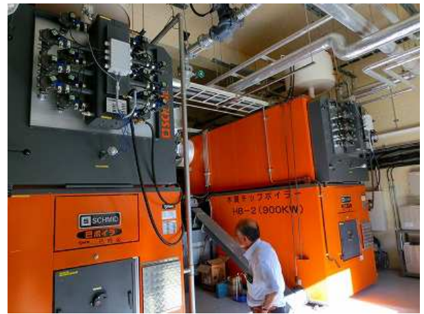
[木質チップボイラー]
